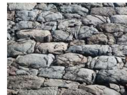
図06 U060_中段_表面劣化(被熱劣化)状況.jpg
