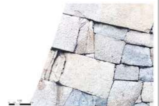
図13 U060_隅角部破損状況01.jpg
