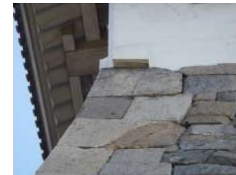
図03 U060_左隅角部の角石割れ.jpg
