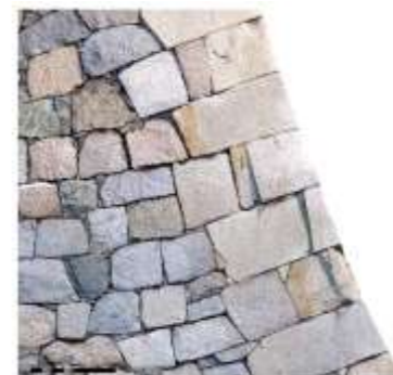
図12 U061_隅角部中段_角石割れ.jpg
