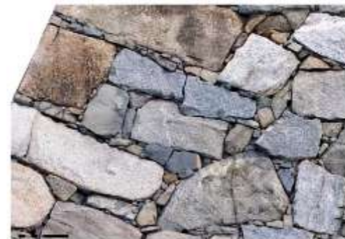
図10 U061_隅角部中段_クリコミ.jpg
