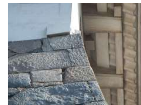
図05 U060_右隅角部の角石、角脇石割れ.jpg
