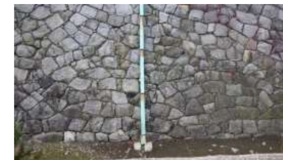
図06 U061_中段下~裾部_損傷(割れ)状況.jpg
