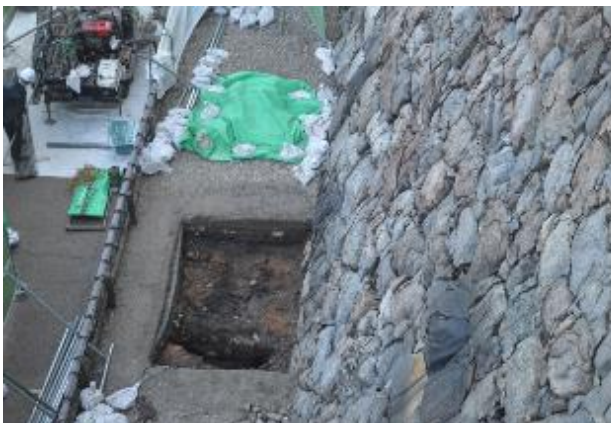
写真 A-3 調査地点遠望。被災した石垣が生々しく見える。／北・上方から
