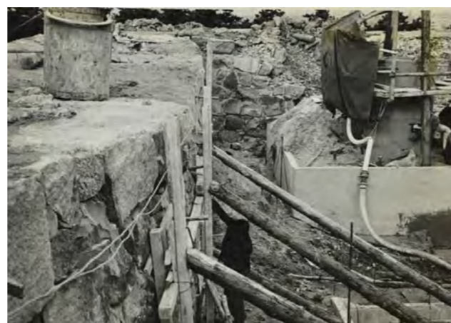
写真(資)-3.4.5 ケーソンの沈下に伴い石垣上部に変形を生じた
