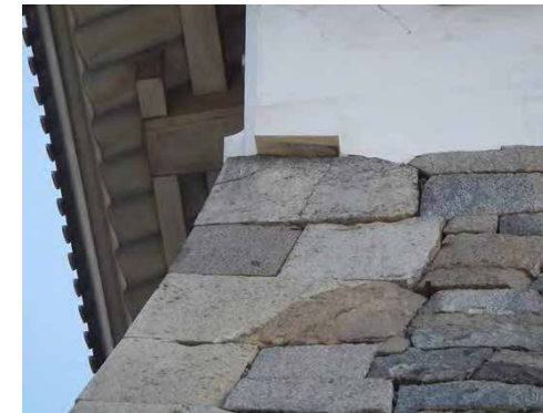
図03 U060_隅角部の角石に見られる割れ1.jpg
