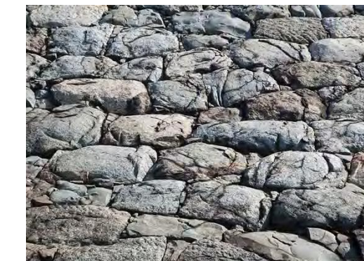
図06 U060_被熱部の状況や中段部間詰石の抜け落ち.jpg
