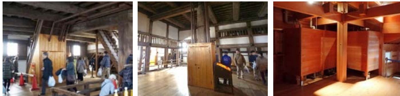
階段下に設置されたアラーム弁室、天井近くを通る主要配管 (写真：竹中工務店撮影)
