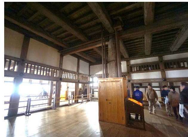
心柱に沿って通る主要配管、横に設置されたアラーム弁室 (写真：竹中工務店撮影)
