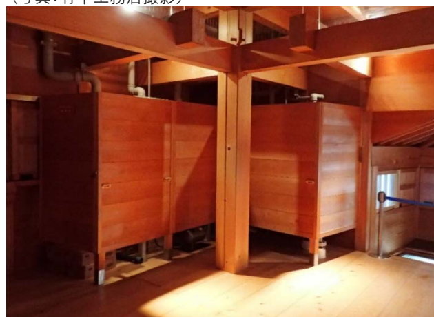
アラーム弁室に施された目隠し (写真：竹中工務店撮影)
