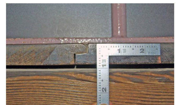
床板の厚さは8分で、傍は相欠としている現存類例。 姫路城大天守三階床板(竹中工務店撮影)
