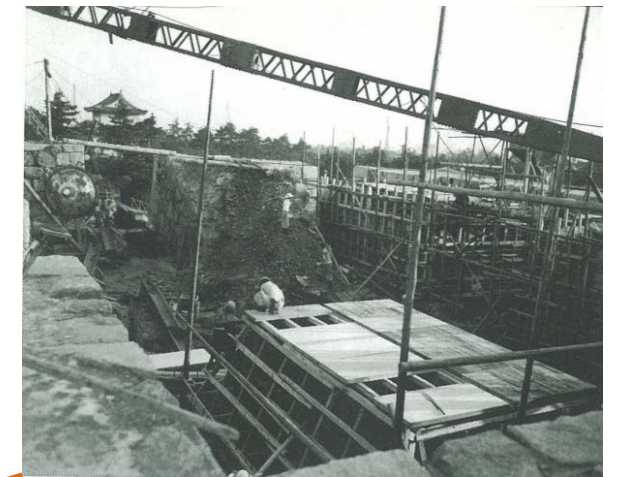
『名古屋城再建』p.26 昭和32年8月1日の記事 入口樹形のL型部石垣がケーソンと干渉するため撤去されている
