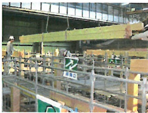
写真-1 内部足場(例)
