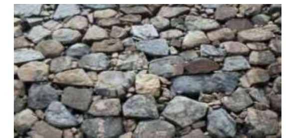
図06 U065_築石の割れ・表面劣化1.jpg
