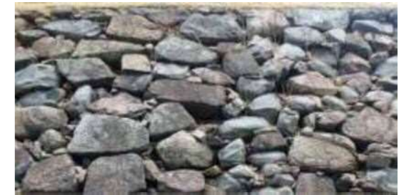
図03 U065_間詰め石の抜け落ち1.jpg
