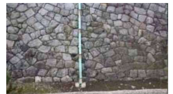
図06 U061_中段下~裾部_損傷(割れ)状況.jpg
