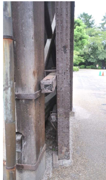
控え柱と門の抵触状況 （北より見る）
