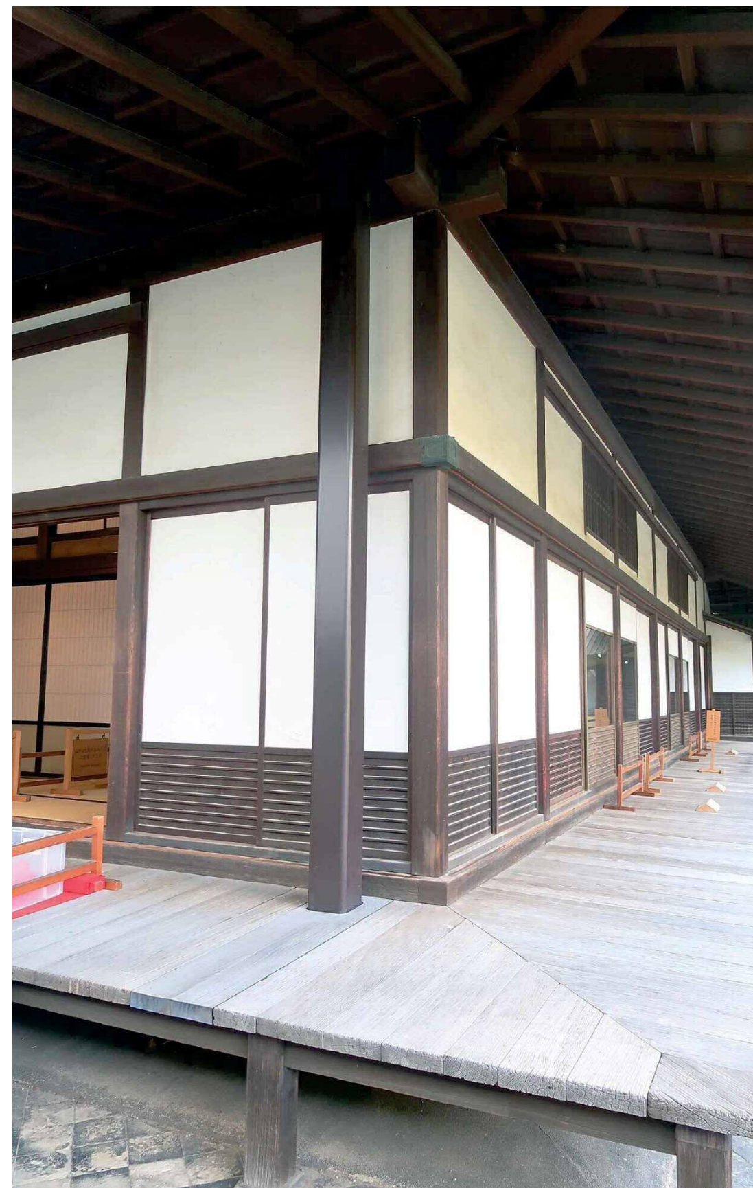
濡縁部分で目立たない色調で鉄骨補強がされている。
