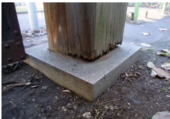
写真 2-11【二之丸大手二之門（A04）】柱脚腐朽
