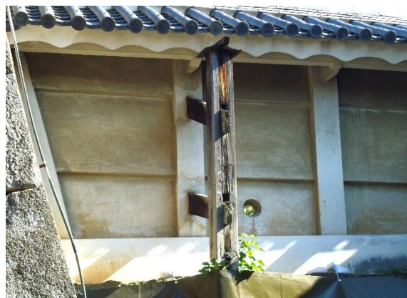
写真 2-10【表二の門附属土塼（A04'）】控え柱腐朽
