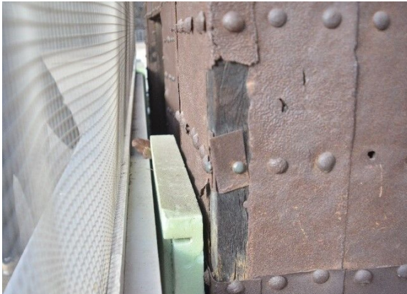
写真 2-8【表二の門（A04）】金属腐食
