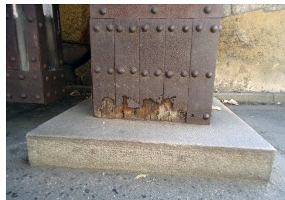
写真 2-12【二之丸大手二之門（A04）】金属腐食
