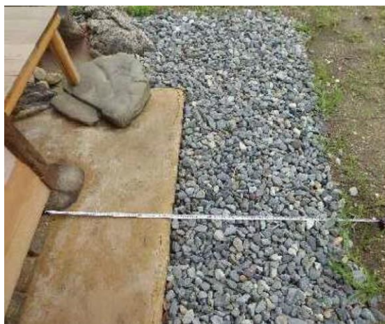
写真1 現状の三和土・雨落ち
