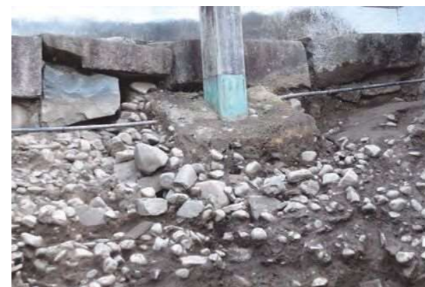
図 20 東側土塀 天端石の下に根固めが入り込む
