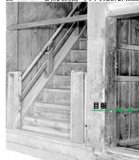
写-6.2.44 「小天守内階(焼失)東南側」(部分)
