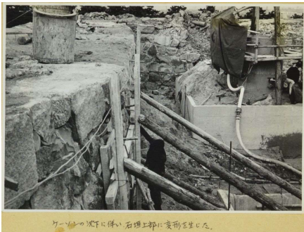
ケーソンの沈下に伴い石垣が内側に 変形している
