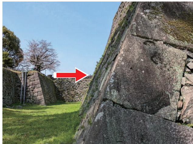
石垣面での膨らみ状況
