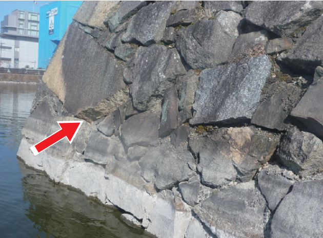
角石の割れ状況
