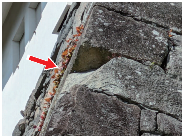
角石の割れ状況
