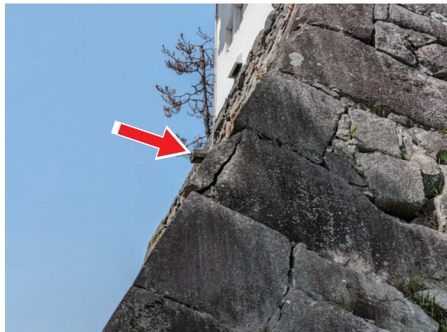
角石の割れ状況
