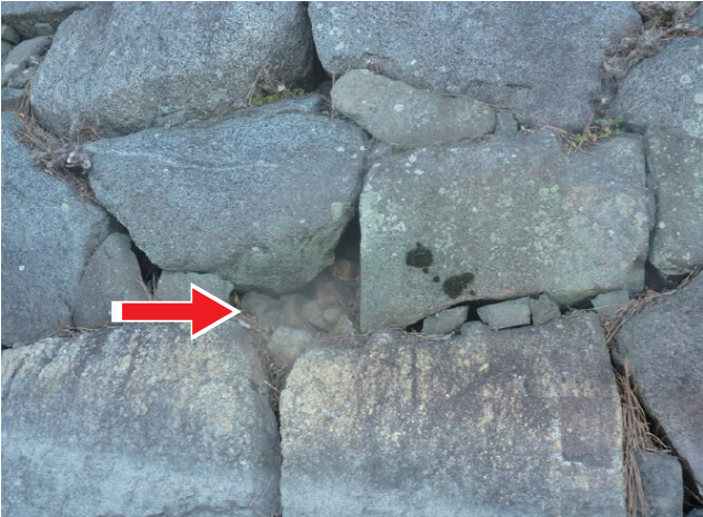
間詰石の抜け状況
