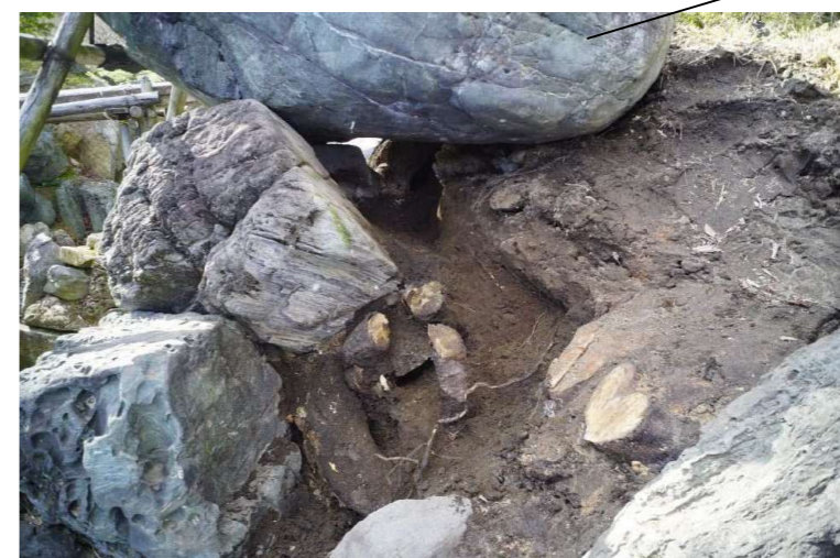
東側面の空隙状況
