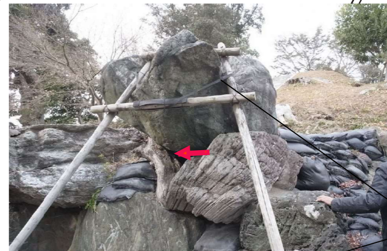
南面の樹木根の状況
