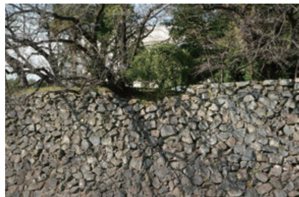
図 4-36 149N 石垣上の局所的崩落
