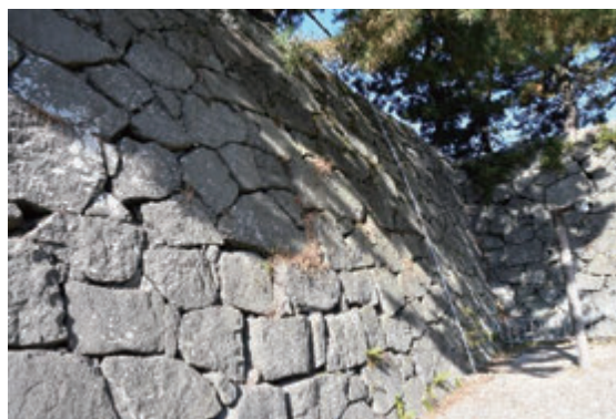
図 4-12 038H 石垣面の膨らみ
