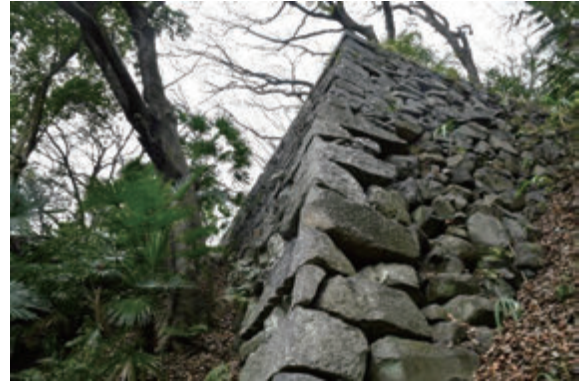
図 4-55 320S-321S 隅角部の状況
