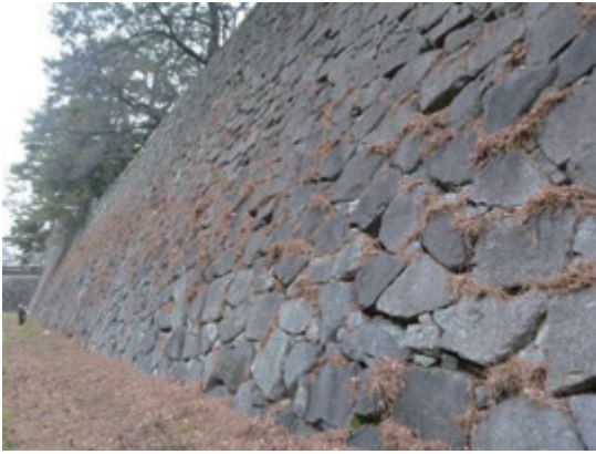
図 4-41 253W 石垣面の膨らみ
