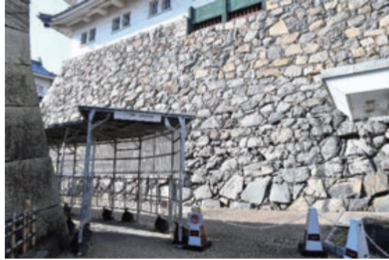
図 4-16 056H(U62) の表面被熱と動線上仮設屋根
