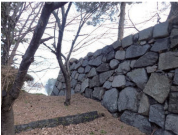
図 4-52 339S 天端石の一部崩落
