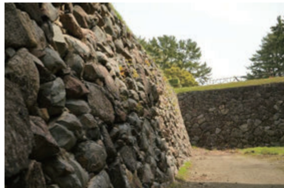
図 4-18 013H(U65) 石垣面の破損状況
