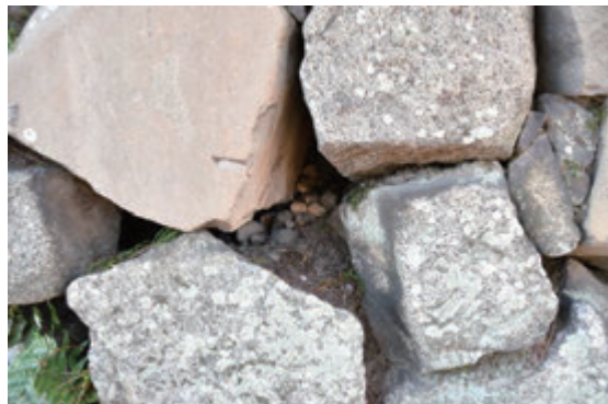
図 4-44 236〇 築石間の隙間
