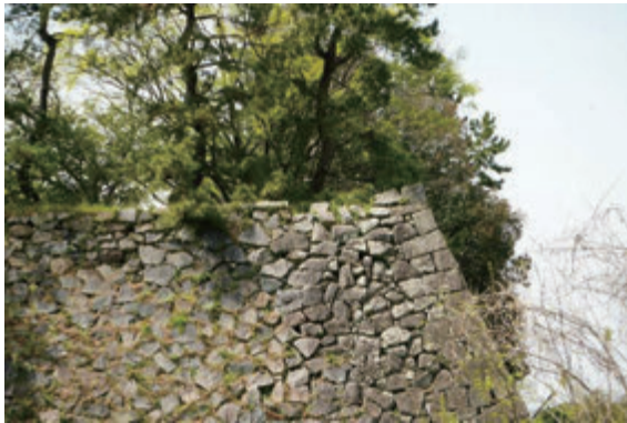
図 4-27 135N 天端の一部欠落
