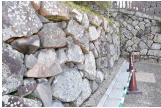
図 4-14 094H 石垣面の膨らみ
