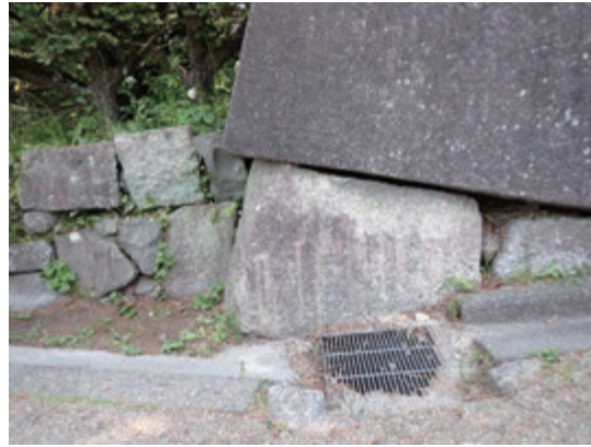
図 4-22 127H 隅角石の割れ
