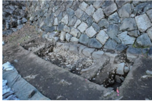
図 4-46 221〇 地中部の段差
