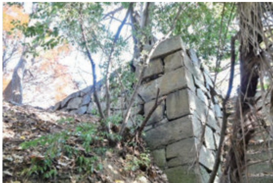
図 4-24 070H 樹木による石垣の変形
