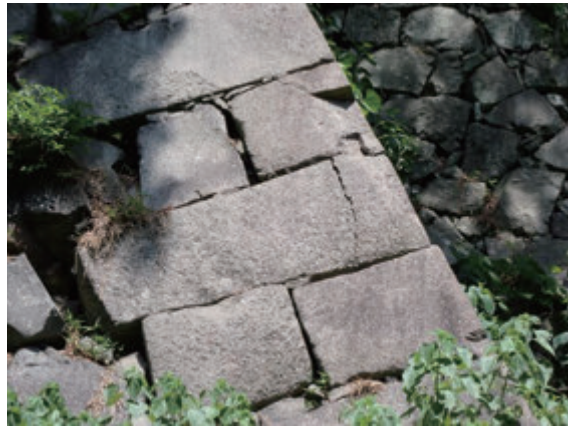
図 4-42 126H 隅角石の割れ
