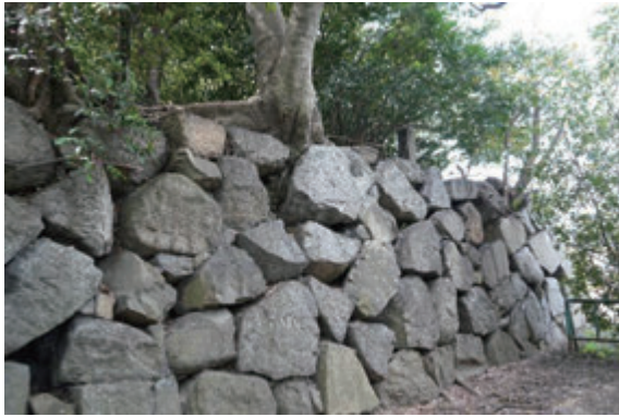
図 4-51 248〇 樹木根による石垣の変形
