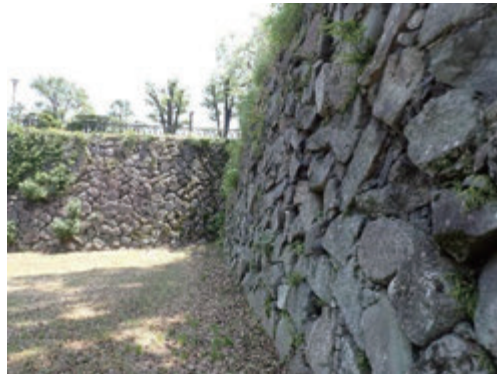
図 4-22 027H 石垣面の膨らみ
