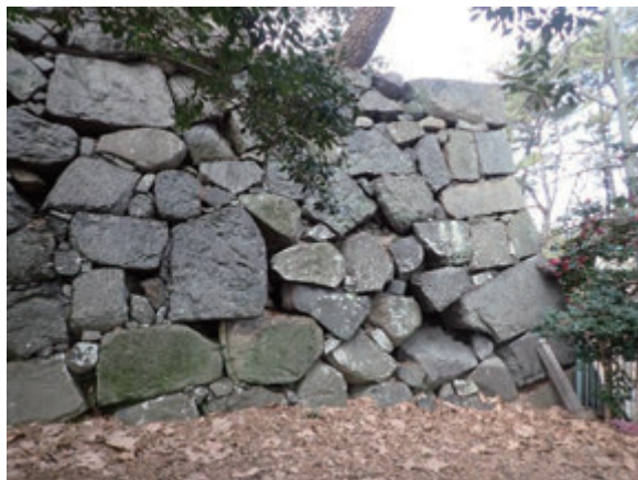
図 4-31 167N 石垣面の緩み
