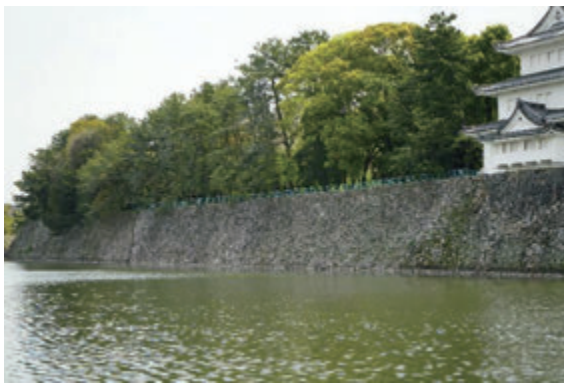
図 4-47 224〇 石垣面の段差
