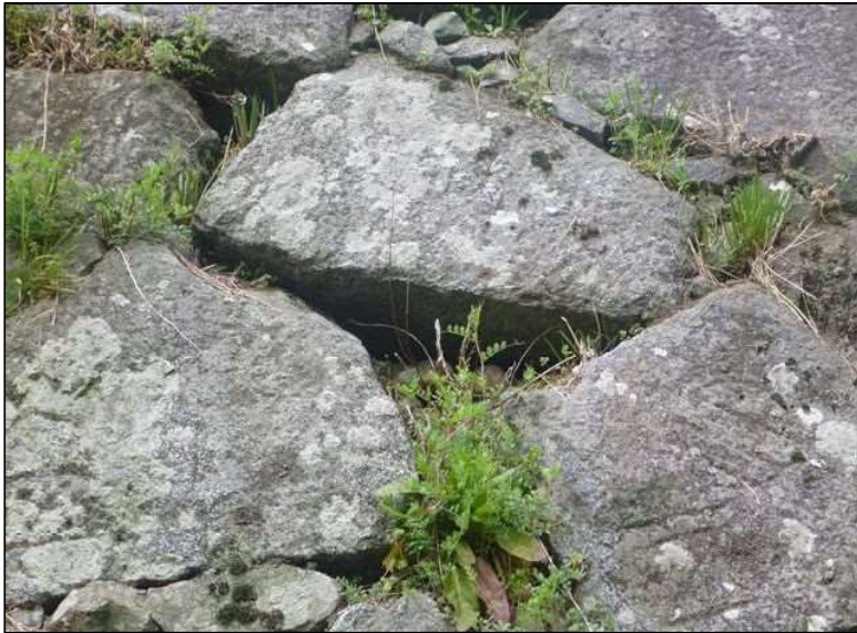
No.:5 石垣名称 本丸地区 021H 内容 間詰石の抜け
