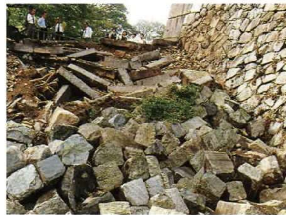
④二之丸東二の門 (北側) 平成6年崩落時
