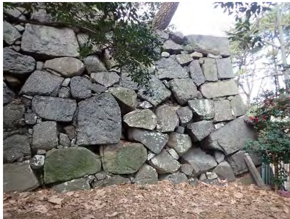
図 4-35 167N 石垣面の緩み
