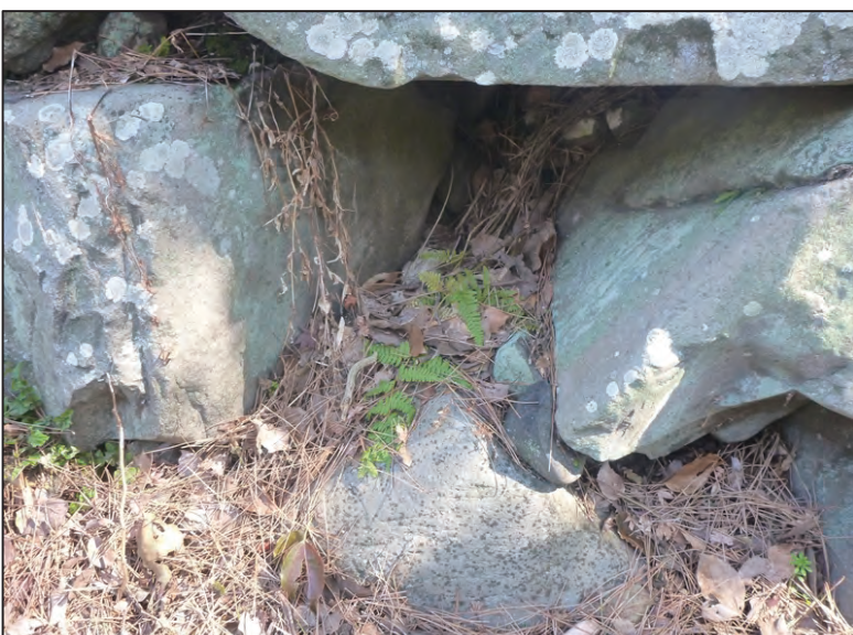
No.: 3 石垣名称 本丸地区 037H 内容 間詰の抜け
