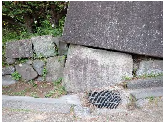
図 4-26 127H 隅角石の割れ
