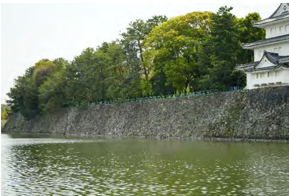
図 4-52 224〇 石垣面の段差
