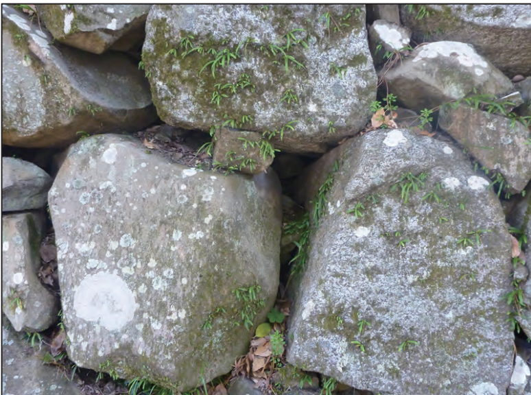
No.: 2 石垣名称 本丸地区 037H 内容 間詰の抜け
