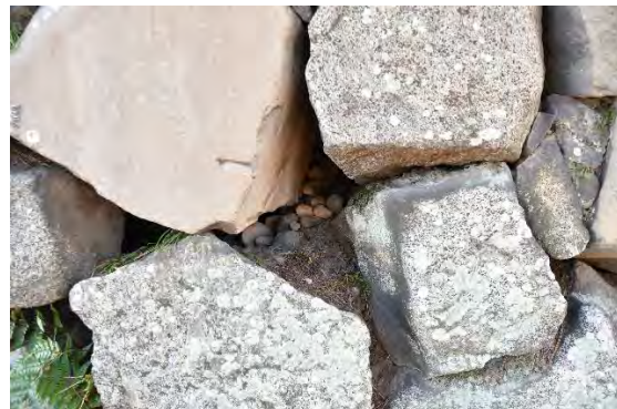
図 4-49 236〇 築石間の隙間
