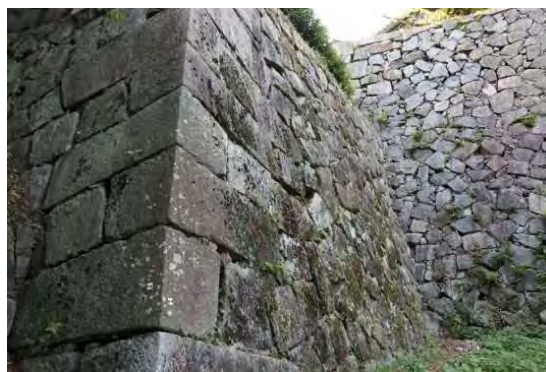
図 4-46 254W 石垣面の膨らみ
