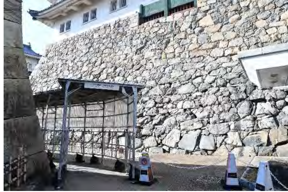
図 4-16 056H(U62)の表面被熱と動線上仮設屋根
