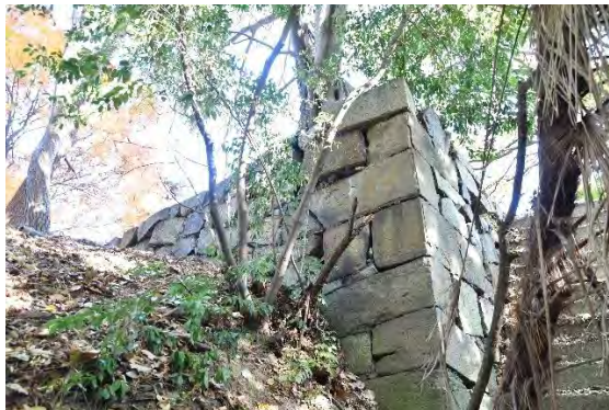
図 4-24 070H 樹木による石垣の変形
