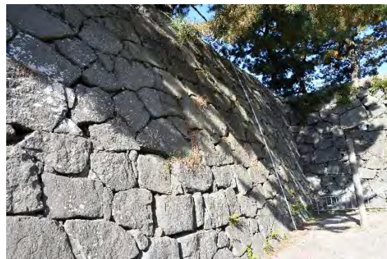
図 4-12 038H 石垣面の膨らみ
