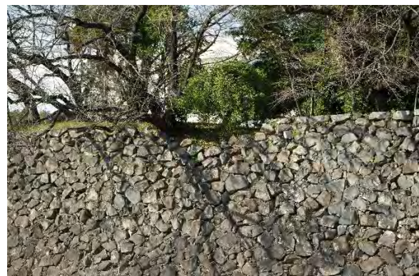
図 4-42 149N 石垣上の局所的崩落
