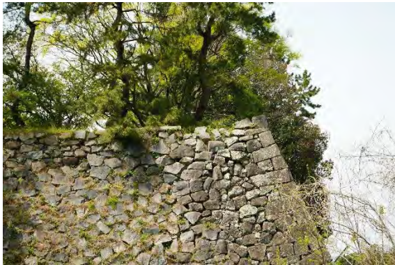
図 4-39 135N 天端の一部欠落
