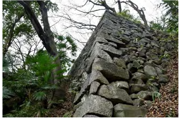
図 4-60 320S-321S 隅角部の状況
