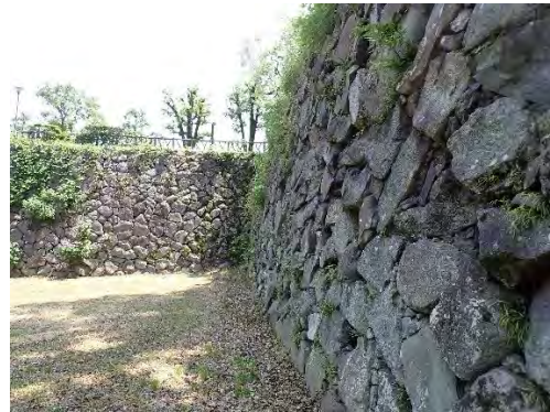
図 4-28 027H 石垣面の膨らみ
