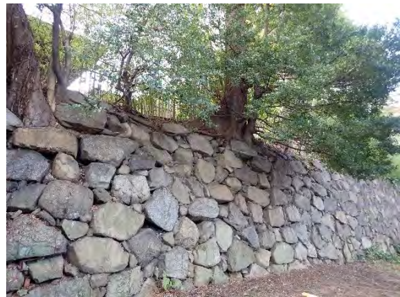
図 4-58 343S 石垣上樹木による石材飛び出し
