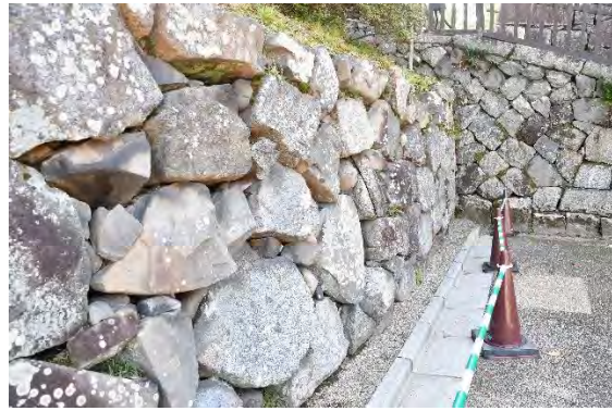
図 4-14 094H 石垣面の膨らみ
