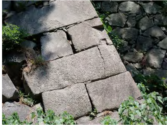
図 4-30 126H 隅角石の割れ
