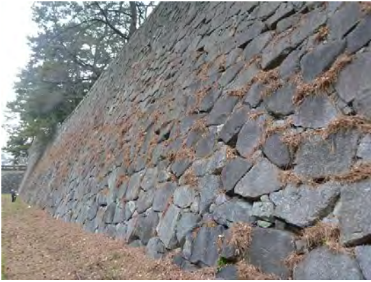
図 4-47 253W 石垣面の膨らみ
