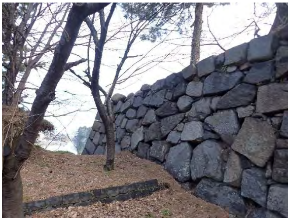
図 4-57 339S 天端石の一部崩落
