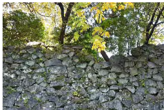
図 4-40 161N 天端部の欠落
