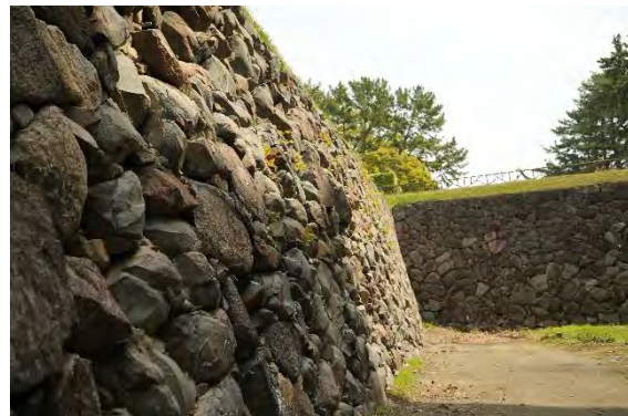
図 4-18 013H(U65) 石垣面の破損状況
