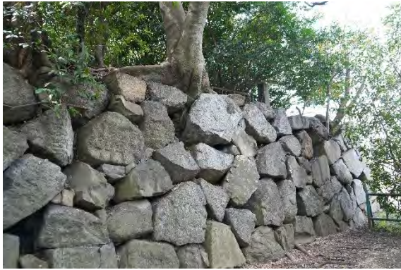
図 4-56 248〇 樹木根による石垣の変形
