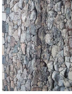
図05 U058_漆喰による築石の劣化状況1.jpg
