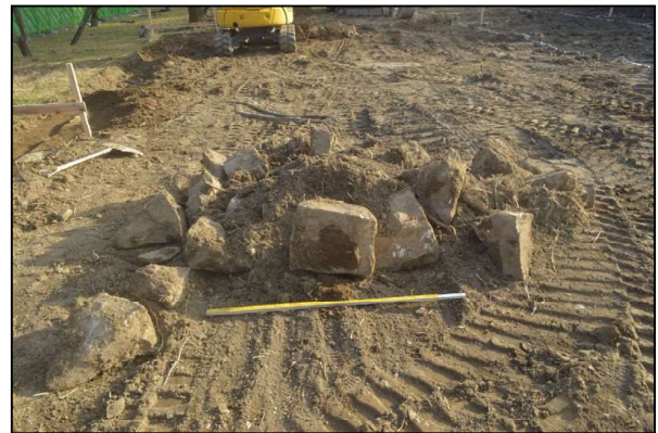
写真3 き損した石材状況／北から
