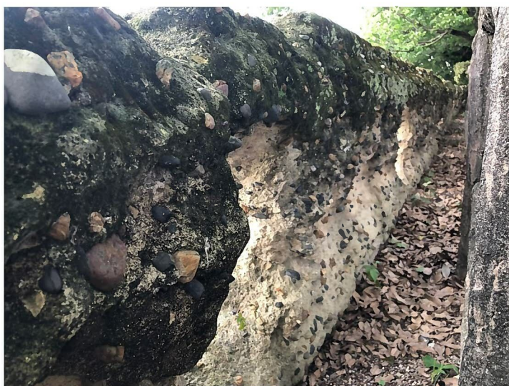
写真 4-1 南蛮練塀劣化状況 1
