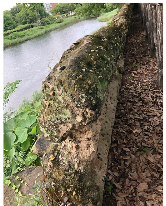
写真 4-2 南蛮練塀劣化状況 2
