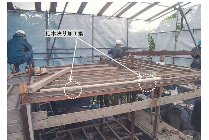
写真④ 天井材解体状況（H23年度） 天井材は当初材が残存していた。廻縁上の胴縁材天端に、使用していない桔木決りの痕跡があった。
