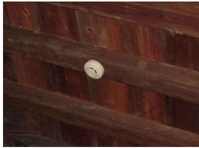
自動火災報知設備 (煙)
