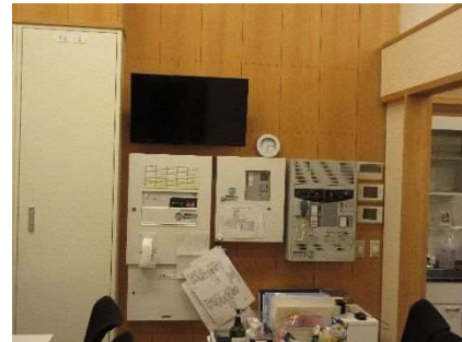
受信盤 (本丸御殿夜間警備員詰所)
