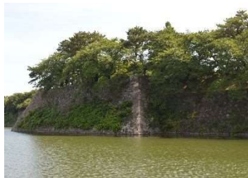
石垣を被覆する草本類 （西側石垣）
