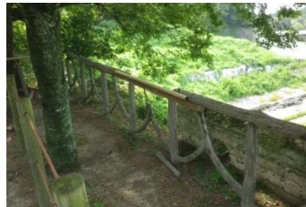
擬木柵の欠損部 (二之丸北南蛮練堀付近)
