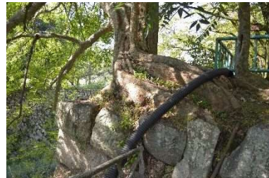
根が石垣をき損している樹木 （御深井丸西側鵜の首）
