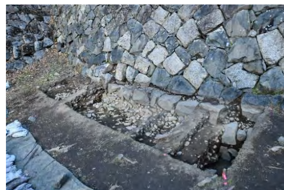
図 4-46 221〇 地中部の段差
