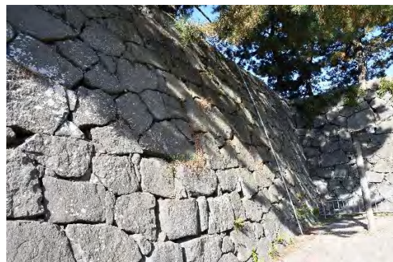
図 4-12 038H 石垣面の膨らみ
