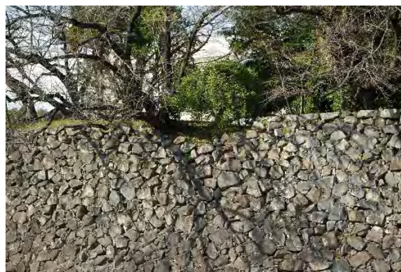
図 4-36 149N 石垣上部の局所的崩落
