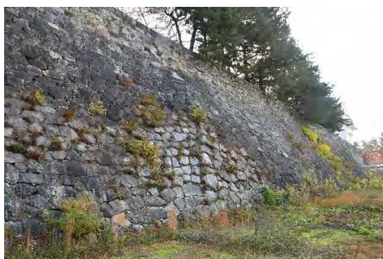
図 4-23 005H(U56) 石垣面の膨らみ
