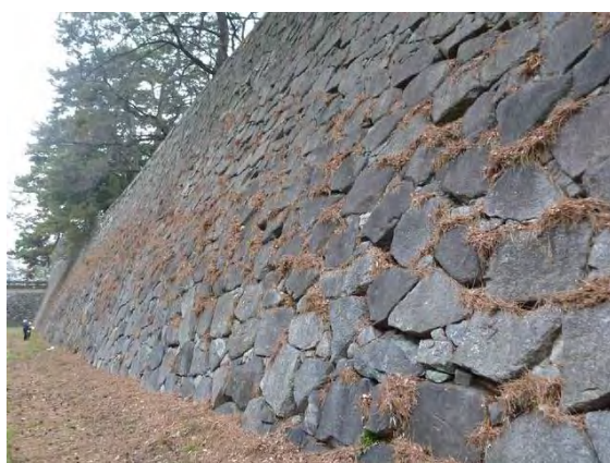
図 4-41 253W 石垣面の膨らみ
