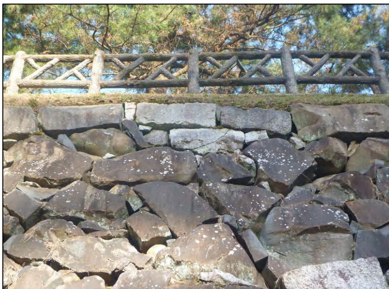
No.: 1 石垣名称 本丸地区 037H 内容 石材の割れ
