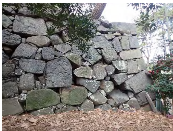
図 4-31 167N 石垣面の緩み
