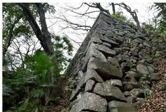
図 4-55 320S-321S 隅角部の状況
