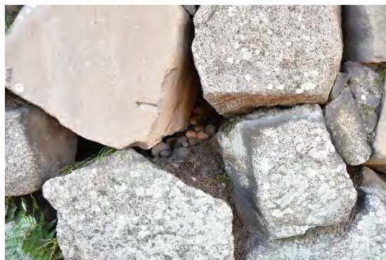
図 4-44 236〇 築石間の隙間
