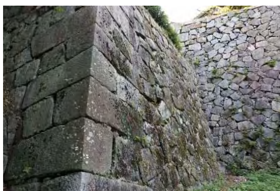
図 4-40 254W 石垣面の膨らみ
