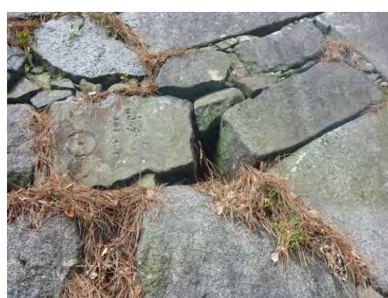
図 4-42 126H 間詰め石の抜け
