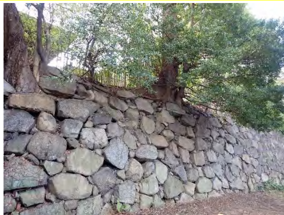
図 4-53 343S 石垣上樹木による石材飛び出し
