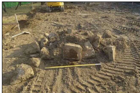
写真3 き損した石材状況／北から
