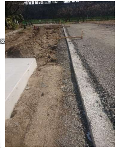
②学芸員の立会いなく、掘削と基礎施工が行われていたもの
