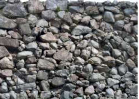
図09 U065_築石の割れ.jpg
