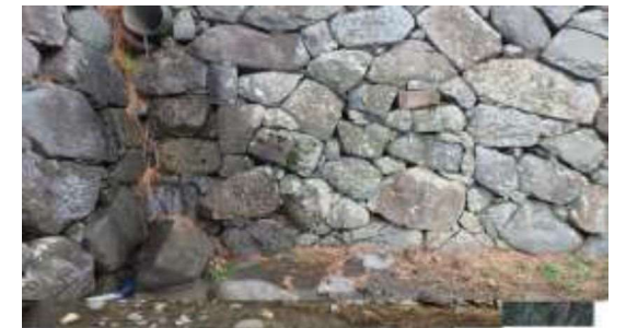
図04 U065_間詰め石の抜け落ちと築石の割れ1.jpg
