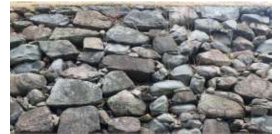
図03 U065_間詰め石の抜け落ち1.jpg
