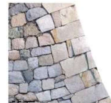
図12 U061_隅角部中段_角石割れ.jpg
