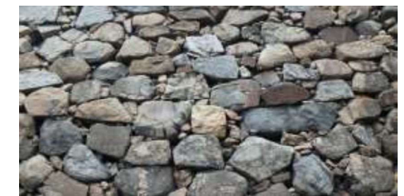
図06 U065_築石の割れ・表面劣化1.jpg
