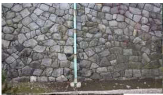
図06 U061_中段下~裾部_損傷(割れ)状況.jpg
