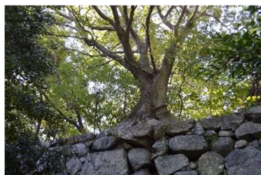
石垣の保存に影響を与える樹木 (西側多聞櫓台石垣)
