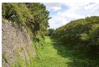
堀に繁茂した草本類 （西之丸南）
