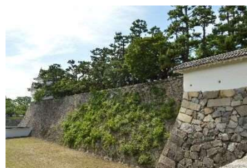
石垣を被覆している草本類 （大手馬出東側）
