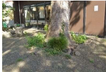
園路舗装の不陸を生じさせている クスノキ（売店・飲食店南）
