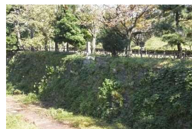
石垣を被覆している草本類 （二之丸埋門付近）
