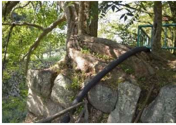
石垣をき損している樹木（アキニレ） （西側鵜の首）
