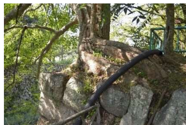
根が石垣を毀損している樹木 （御深井丸西側鵜の首）
