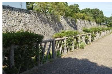
補植されていない灌木 （東南隅櫓東）
