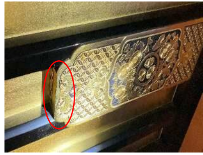
写真 22 板金具の緑青
