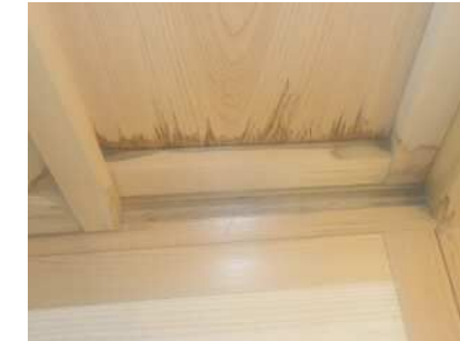
写真 8 柱・敷居のシミ
