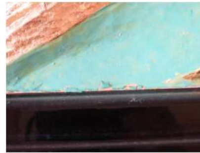
写真 20 彫刻欄間 彩色剥がれ
