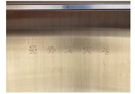
写真 47 屋外消火栓表示剥がれ
