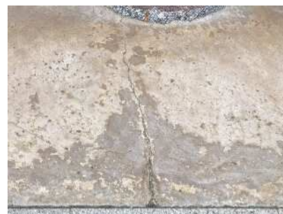
写真 39 三和土の割れ
