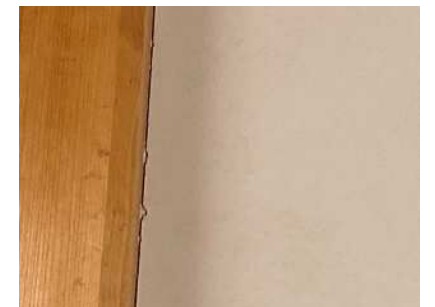
写真 12 土壁のちり切れ
