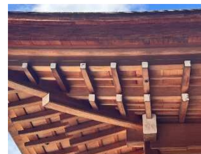
写真 43 木口胡粉の剥離
