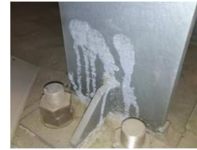
写真 46 ダンパー鉄骨支柱
