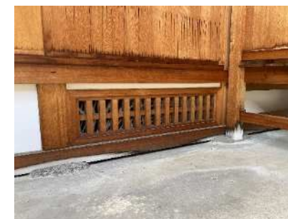
写真 28-1 柱脚、地長押のシミ
