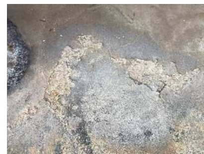
写真 41 三和土の剥離
