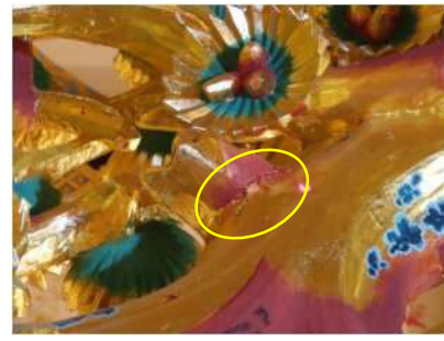
写真 21 彫刻欄間 金箔剥がれ
