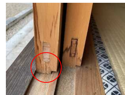
写真 16 建具 縦框の割れ
