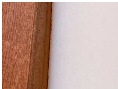
写真 36 土壁のちり切れ
