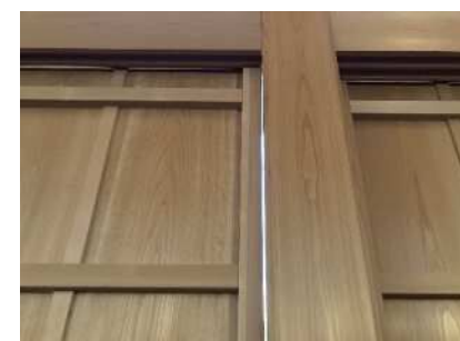
写真 14 建付けの隙間
