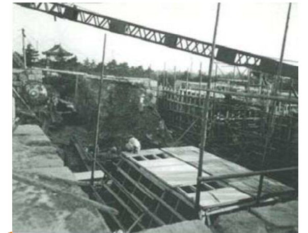
『名古屋城再建』p.26 昭和32年8月1日の記事 入口枳形のL型部石垣がケーソンと干渉するため撤去されている
