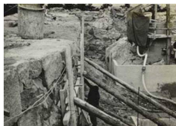
『名古屋城改築工程写真 其一』p.6 「ケーソンの沈下に伴い石垣上部に変形を生じた」
