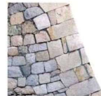
図12 U061_隅角部中段_角石割れ.jpg
