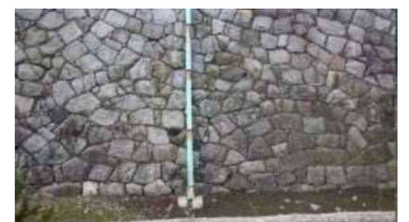
図06 U061_中段下~裾部_損傷(割れ)状況.jpg
