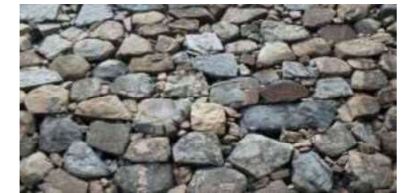
図06 U065_築石の割れ・表面劣化1.jpg
