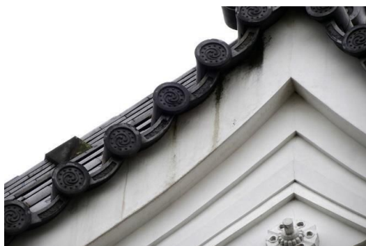
写真 1【西南隅櫓（A01）】裏甲汚損
