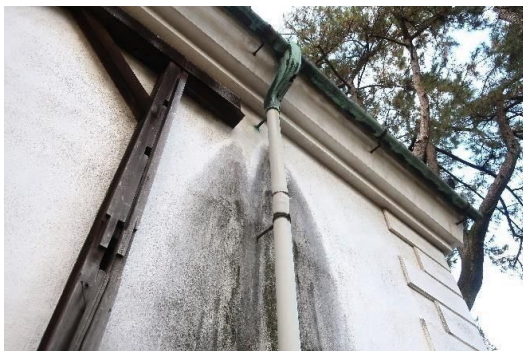
写真 13 【乃木倉庫 (B01)】 鯀鯀孔食、豎樋周り汚損
