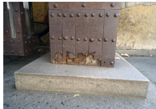
写真 12 【二之丸大手二之門 (A04)】 金属腐食
