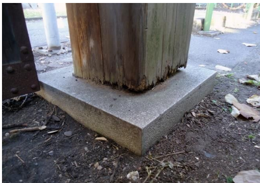
写真 11 【二之丸大手二之門 (A04)】 柱脚腐朽
