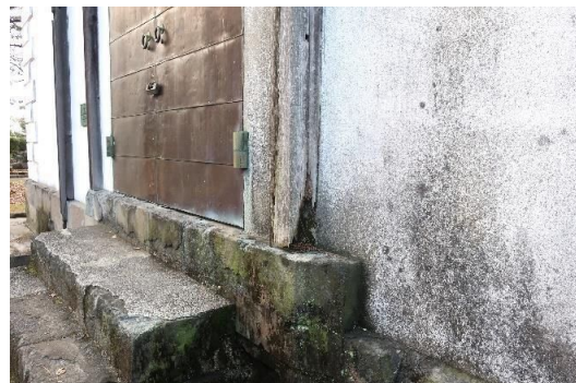
写真 14 【乃木倉庫 (B01)】 付柱腐朽、凝灰岩表面剥離
