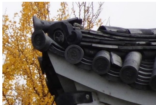
写真 6【西北隅櫓（A03）】瓦の脱落
