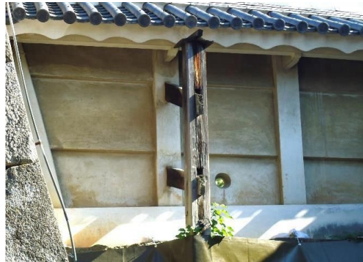
写真 10 【表二の門附属土塀 (A04')】 控え柱腐朽
