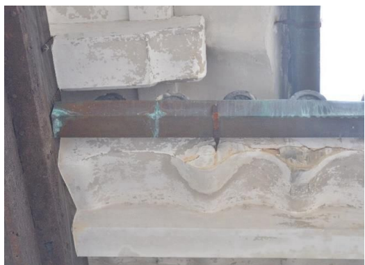
写真 7【表二の門（A04）】漆喰剥離
