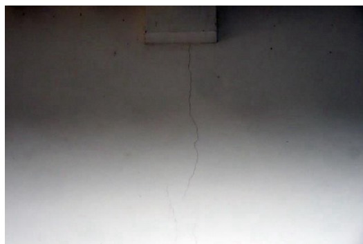
写真 2【西南隅櫓（A01）】壁クラック
