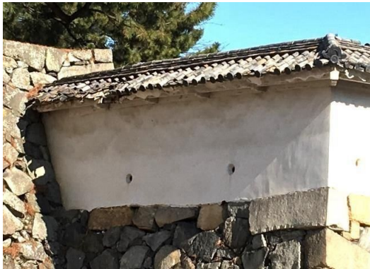
写真 9 【表二の門附属土塀 (A04')】 屋根瓦欠失
