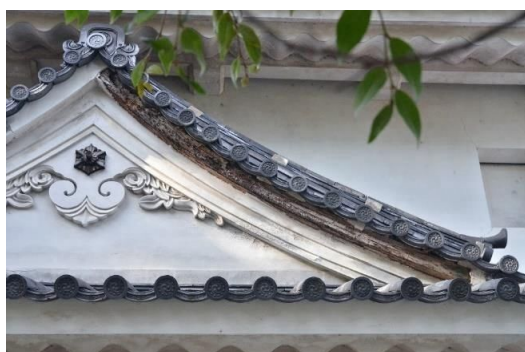
写真 5【西北隅櫓（A03）】漆喰、塗土剥離
