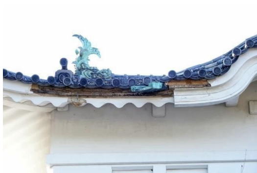
写真 3【東南隅櫓（A02）】漆喰、塗土剥離
