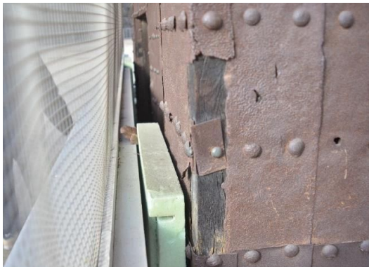
写真 8【表二の門（A04）】金属腐食
