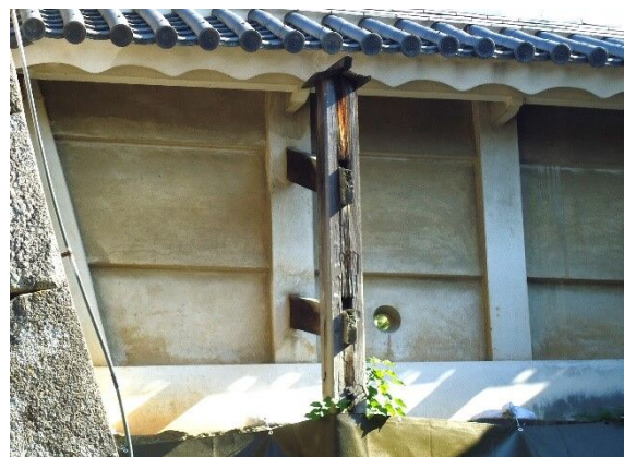
写真 2-10 【表二の門附属土塼（A04'）】控え柱腐朽
