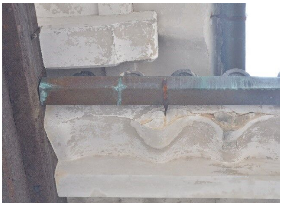
写真 2-7【表二の門（A04）】漆喰剥離
