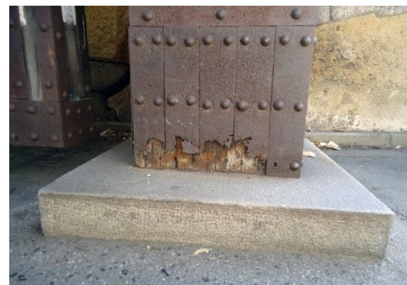
写真 2-12 【二之丸大手二之門（A04）】金属腐食
