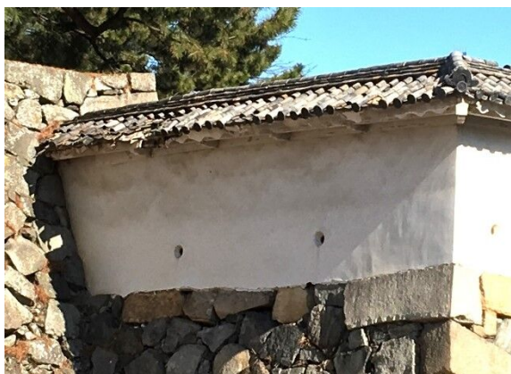
写真 2-9 【表二の門附属土塼（A04'）】屋根瓦欠失
