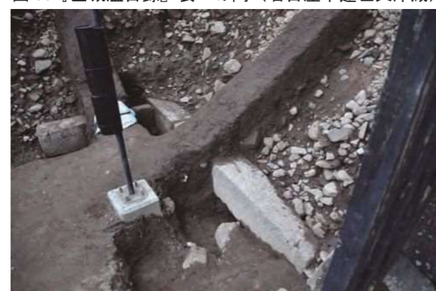
図 18 西側土塀 切石側面の変色
