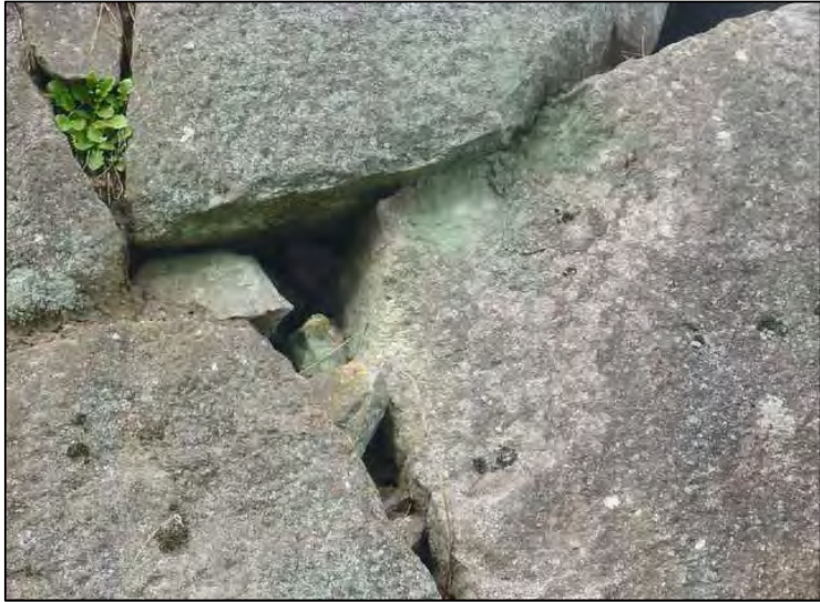
No.: 4 石垣名称 本丸地区 021H 内容 隅角石の欠け
