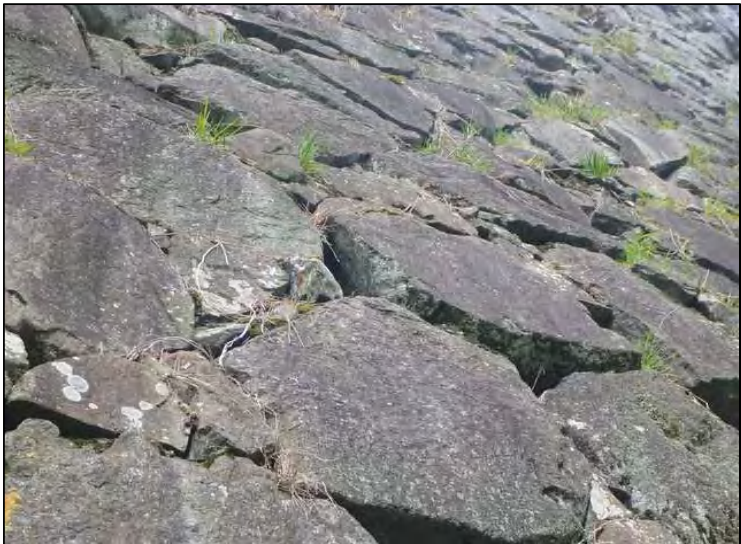
No.: 2 石垣名称 本丸地区 021H 内容 築石のズレ
