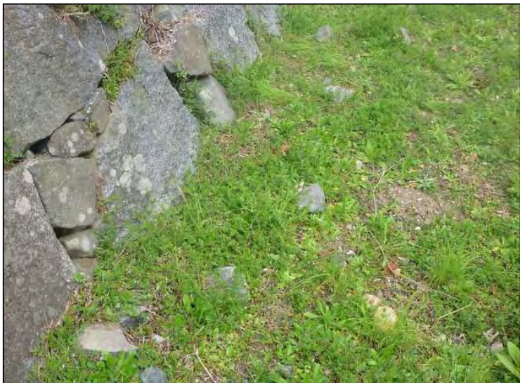
No.: 6 石垣名称 本丸地区 021H 内容 抜け落ちた間詰石
