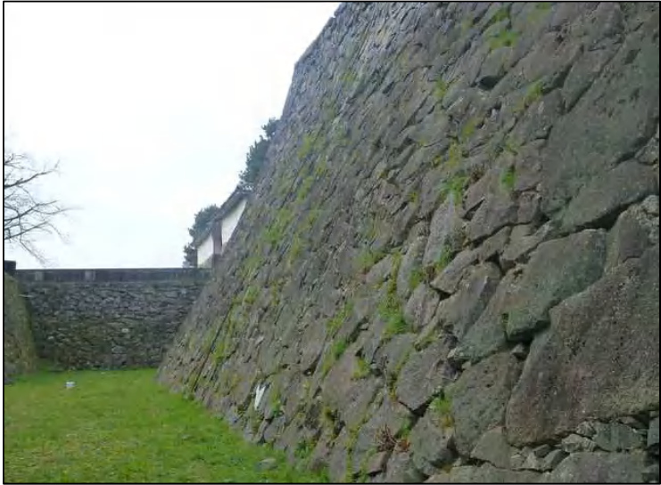
No.: 1 石垣名称 本丸地区 021H 内容 築石部の孕み
