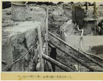
ケーソンの沈下に伴い石垣が内側に變形している
