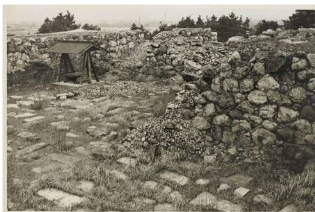
櫓形、開口部周りの角に崩壊している部分がある。
