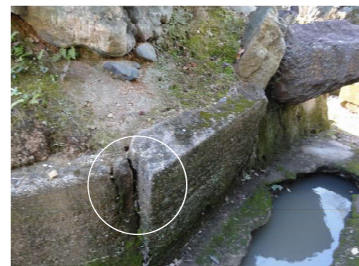
三和土護岸傾倒部(断面)
