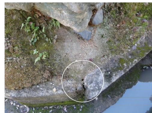
三和土護岸傾倒部(上面)
