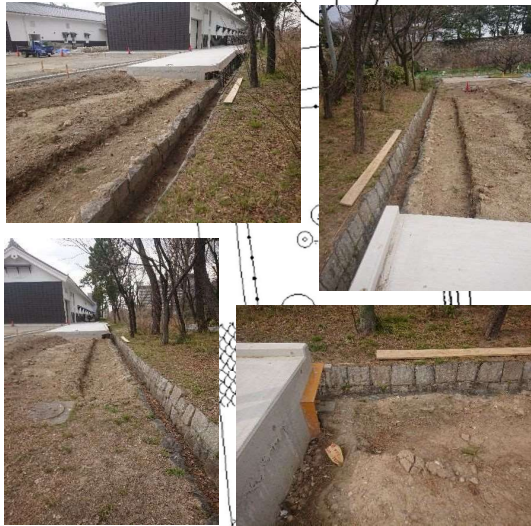
①現状変更許可申請に記載のない掘削を行っていたもの (2/27~2/28頃)
