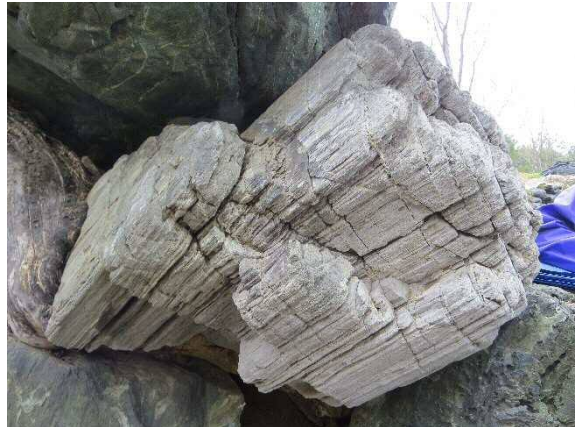
写真 3-2-4 劣化が進行する石材（北園池護岸）
