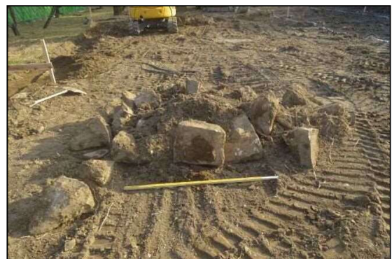
写真3 き損した石材状況／北から
