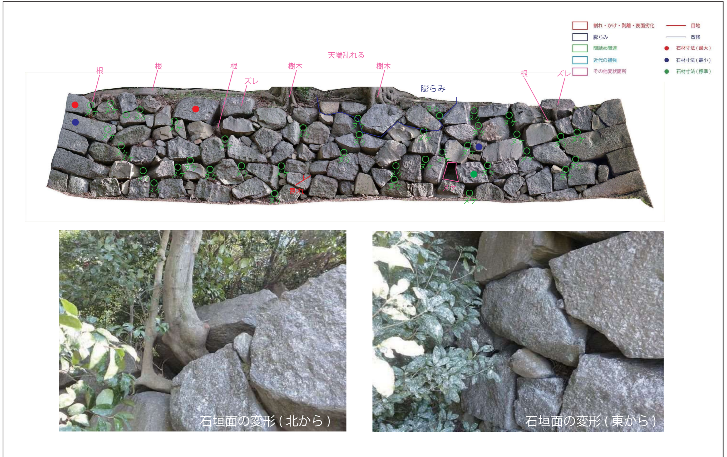
図 11 イ-(エ) 石垣全面での膨らみ (御深井丸 2480 石垣)
