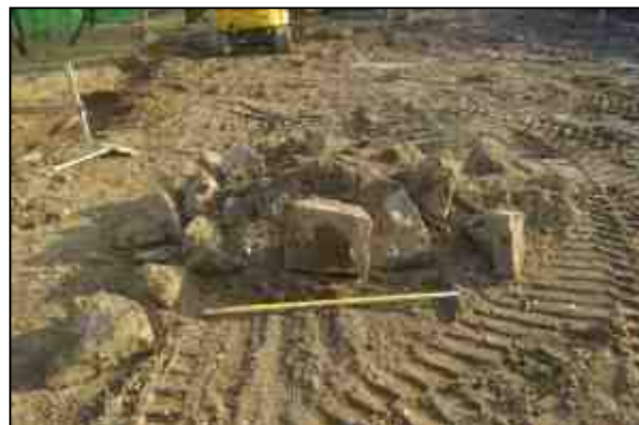
写真3 き損した石材状況／北から
