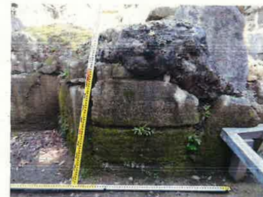
三和土護岸孕み部(北面)
