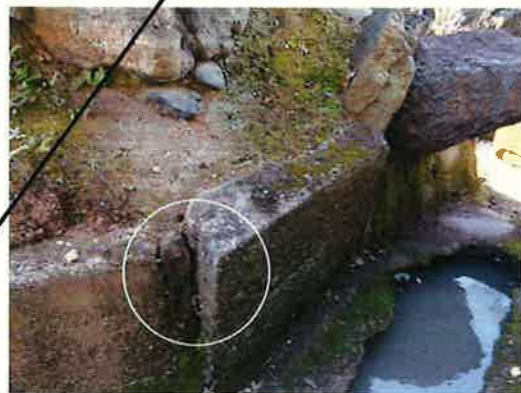
三和土護岸傾倒部(断面)
