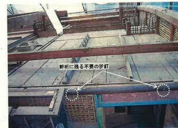
写真③ 小屋組の解体状況（H23年度） 板の間部分の丸太の軒桁に不要の折釘が残存。下屋軒桁の当初材と判断できる。
