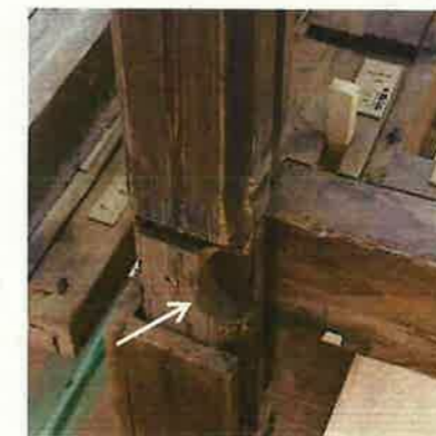
(へ五柱南面) 濡縁框の痕跡
