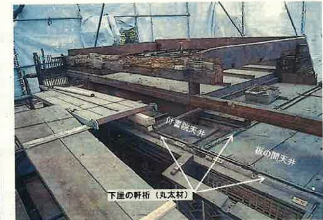
写真② 小屋組の解体状況（H23年度） 下屋軒桁の当初材が残存。丸太の軒桁には、不要の折釘が一定の法則で打たれていた。掛雨戸の掛釘と推定。
