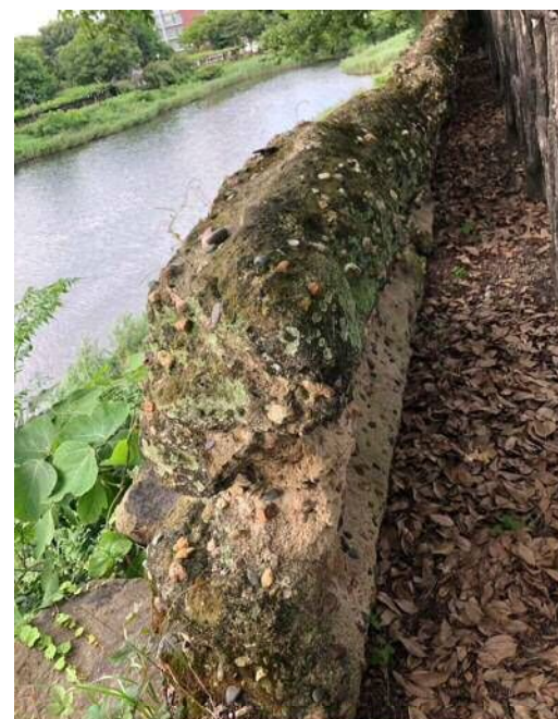
写真 4-2 南蛮練塀劣化状況 2
