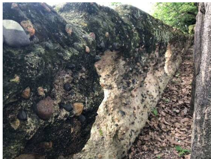
写真 4-1 南蛮練塀劣化状況 1
